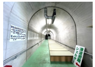
津波避難シェルターの内部には止水扉が2重に設置されている
