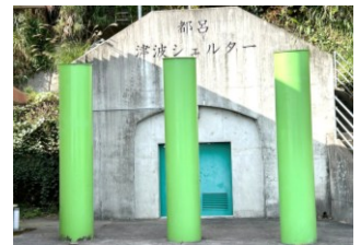
津波避難シェルターの外観 漂流物の衝突を防ぐ鋼鉄製の支柱が建つ
