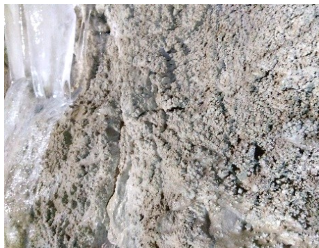
天井から浸みだした地下水由来の石灰石
